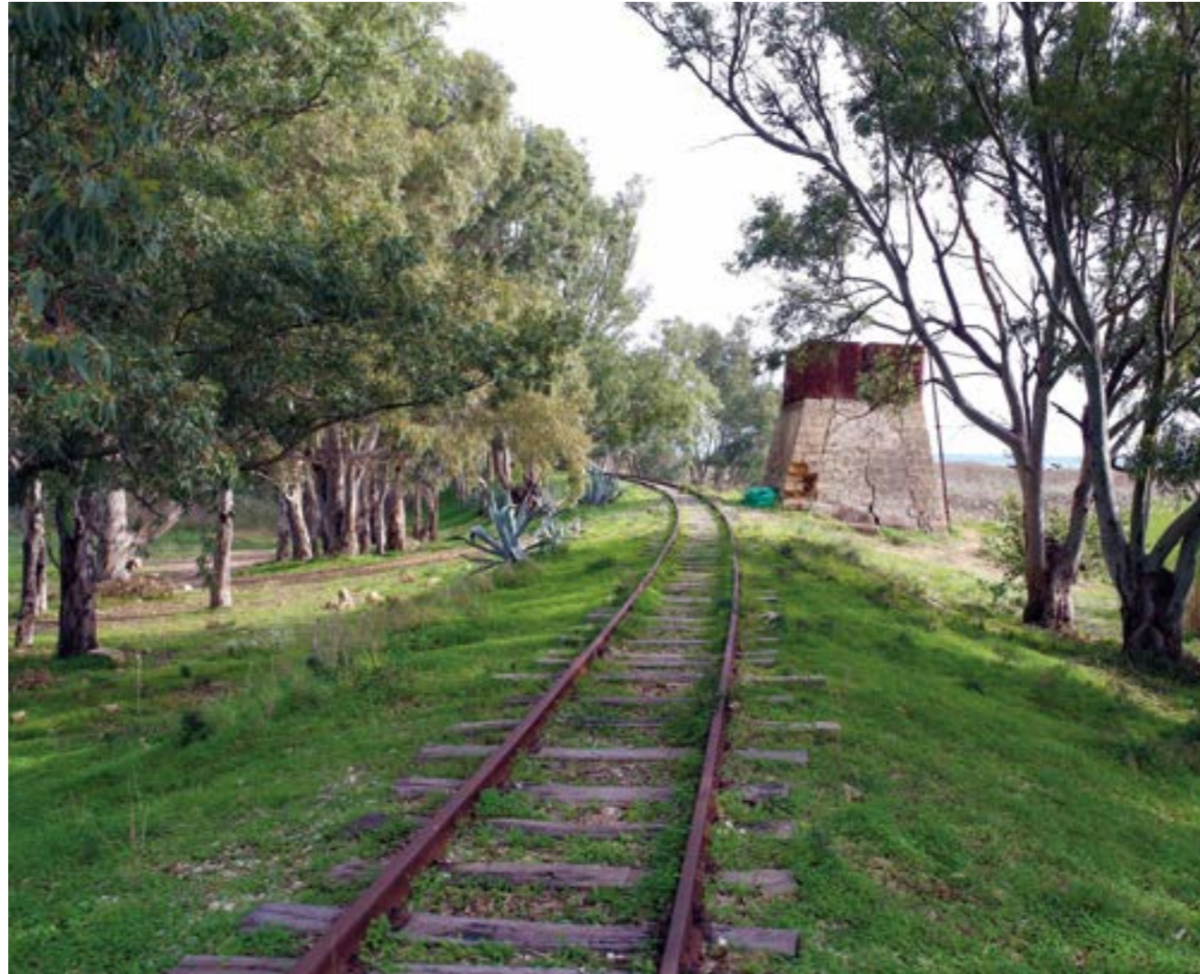
Rifornitore idrico al km 15+460
